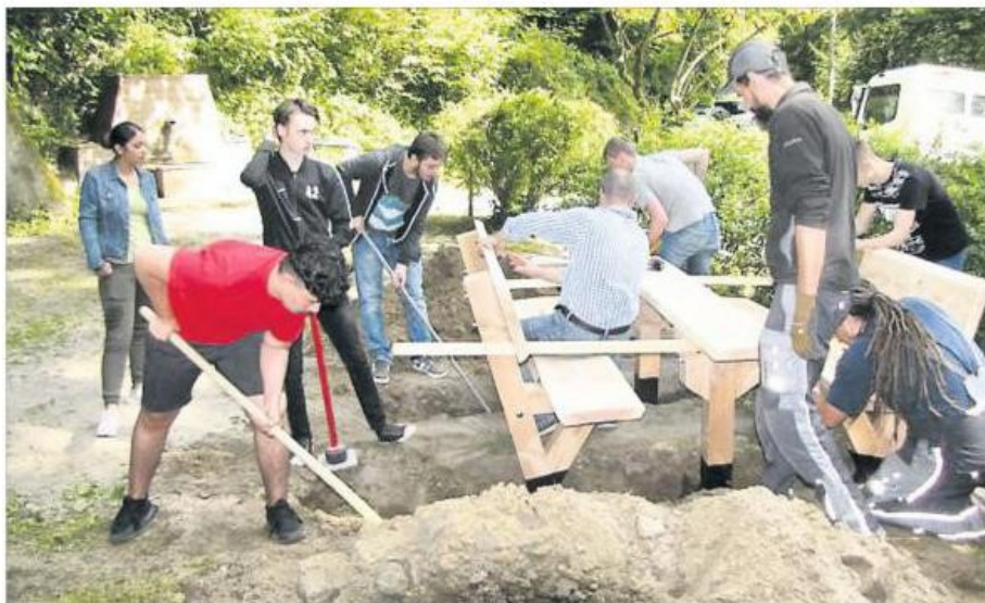
Damit die Sitzgruppe feststeht, müssen die Einbaulöcher wieder gefüllt und die Erde verdichtet werden. Der Lions Club Weinheim unterstützte das Projekt.
